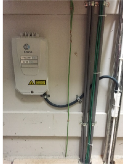
BUDI & Verticasa riser cable
